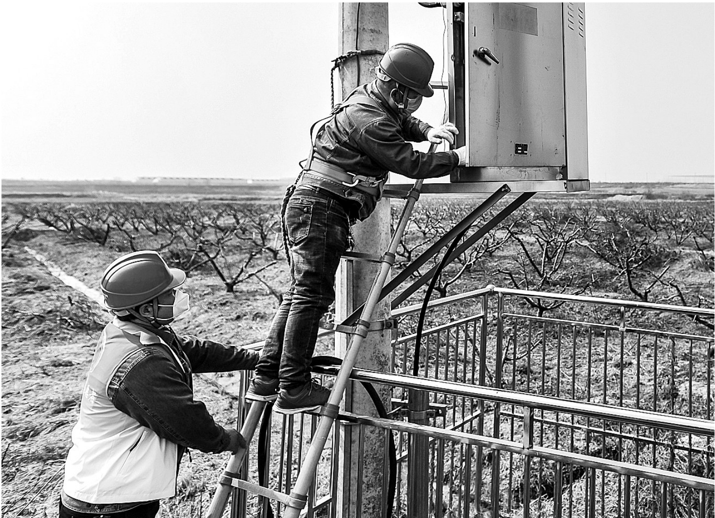
为确保春耕生产顺利进行,安徽电力定远供电公司组成党员技术服务小分队,深入果园棚地、村居农舍,义务维护检修线路设备和配电装置,护航春耕生产。图为近日,志愿者来到吴圩镇千亩水蜜桃园,检修用电设备。
