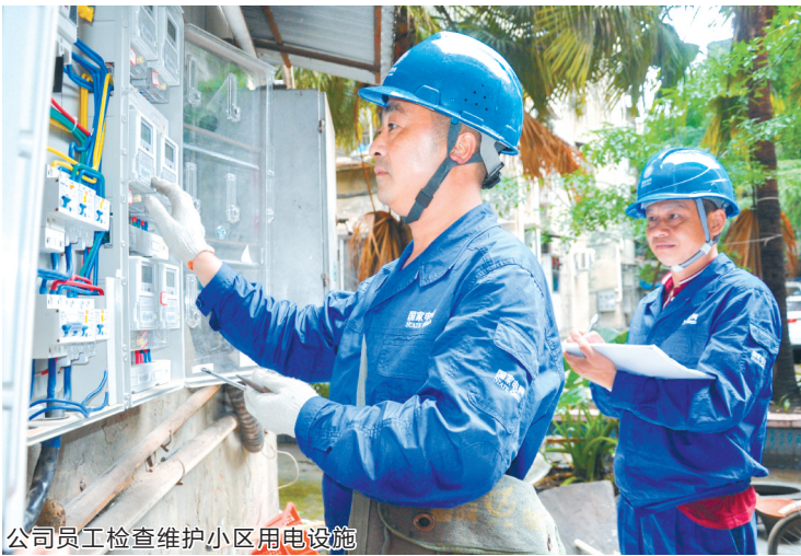
公司员工检查维护小区用电设施
