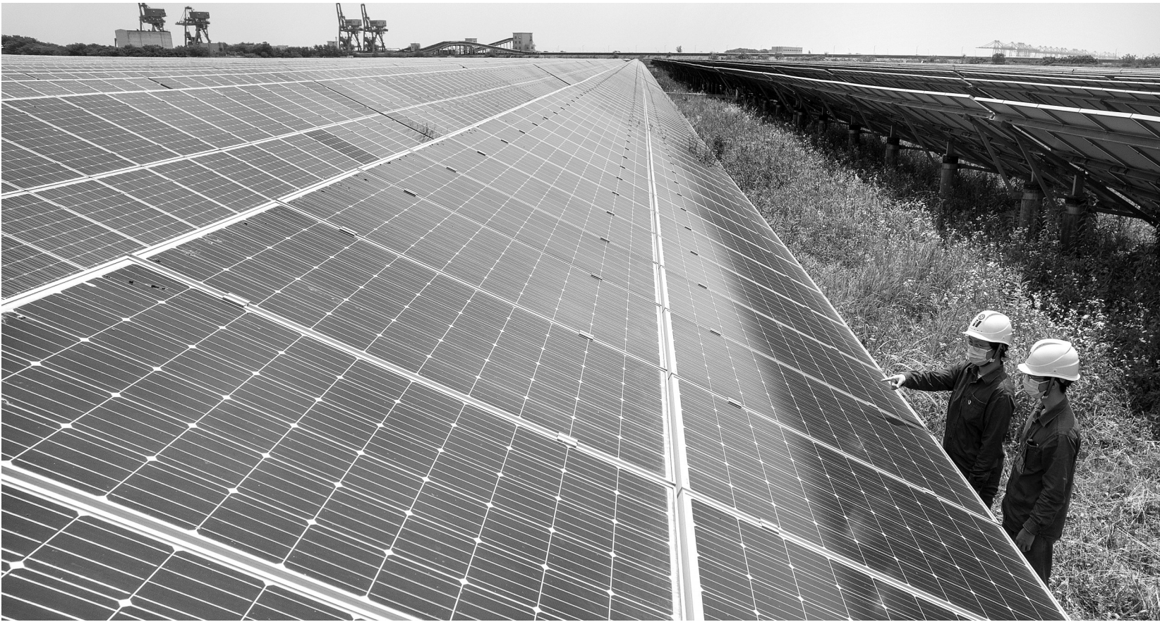
近几年，江苏省太仓市大力发展光伏发电等清洁高效能源产业，华能太仓发电有限责任公司利用江滩建设的50兆瓦集中式光伏电站，由190008块光伏板组成，建成运营四年多来，平均每年发电量5782万度。图为5月23日，技术人员正对沿江光伏电站进行巡查。
