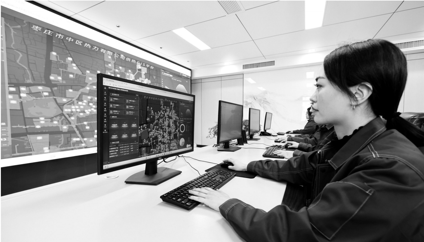
11月12日，受寒潮天气影响，山东省枣庄市气温大幅下降。该市中区采用AI智慧供热系统对城市热用户启动供热。近年来，该区将城市供热系统进行了AI智能化改造，做到精准供热、按需送热、实时管热，降低了损耗，节能减排，为广大居民创造了一个舒适、温暖、低碳化的生活环境。图为工作人员在AI智慧供热控制中心工作。
