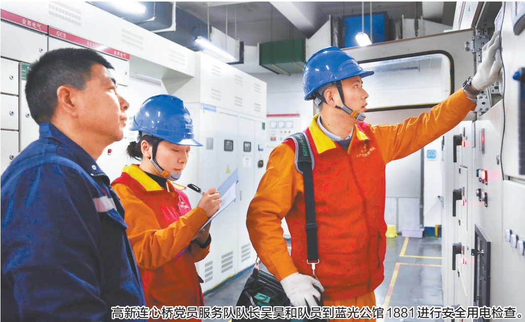
高新连心桥党员服务队队长吴昊和队员到蓝光公馆1881进行安全用电检查。
