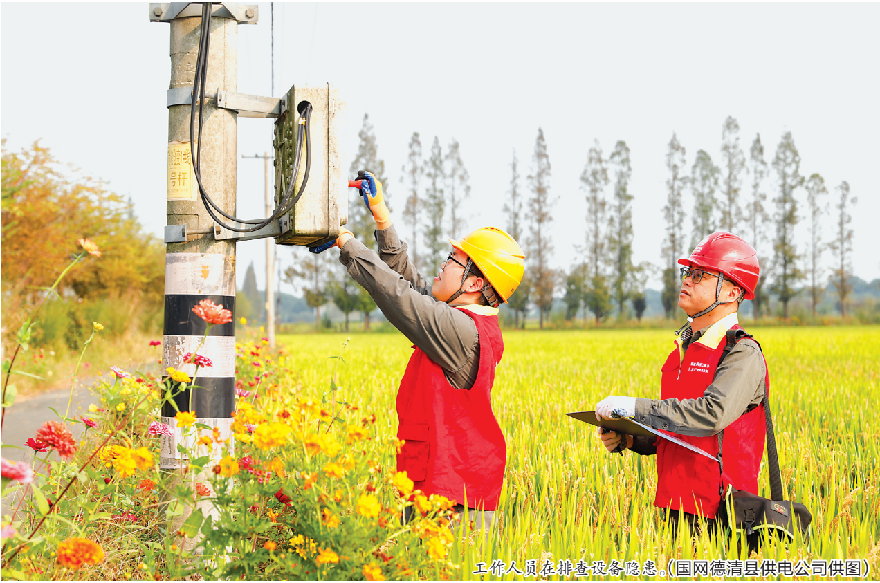
工作人员在排查设备隐患。（国网德清县供电公司供图）
